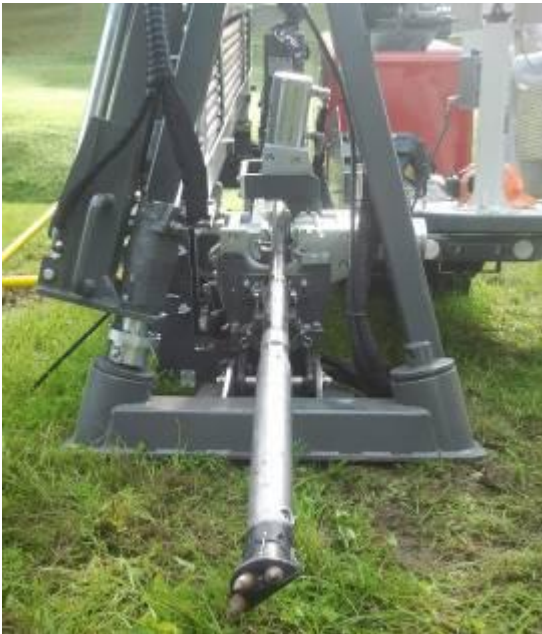
Début du trou pilote. La tête 3 doigts est adaptée aux sols durs et caillouteux.
