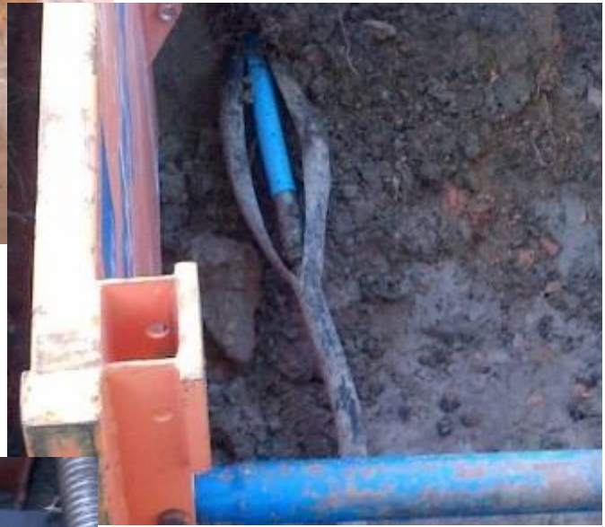
→ L'ancien tuyau est découpé en deux moitiés, et le nouveau tuyau (bleu) est introduit.
